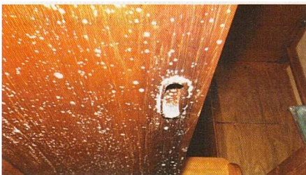
FLECKIGE TÜR Feuchtigkeit hat sich auf dem Holz niedergeschlagen, großflächig bildete sich Schimmel
